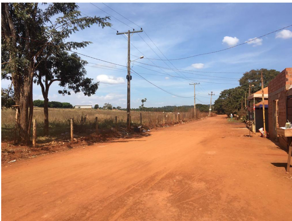
Rede de transmissão de energia elétrica do Residencial JK
