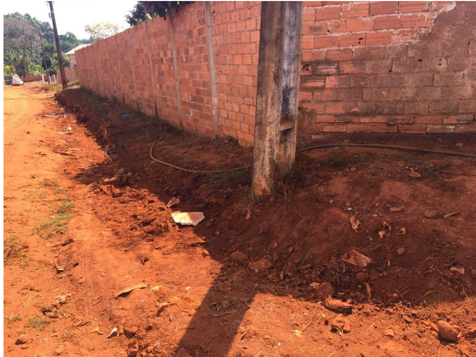
Sistema de distribuição de água improvisado pelos moradores
