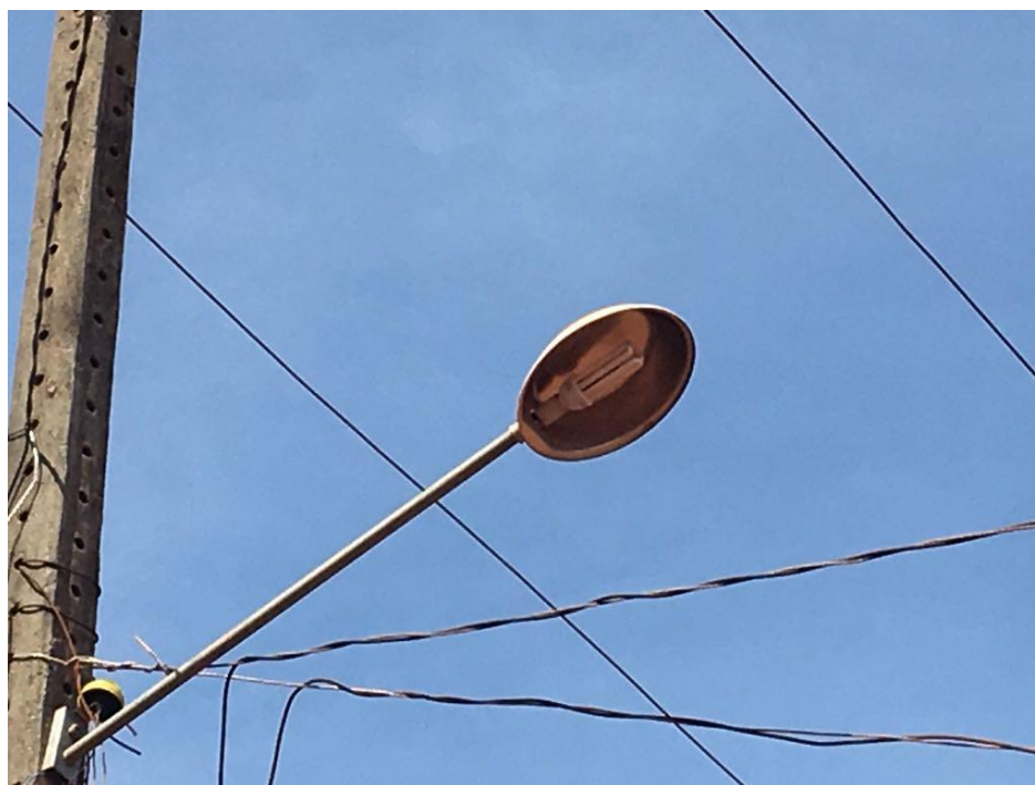
Poste com lâmpada substituída pelos próprios moradores
