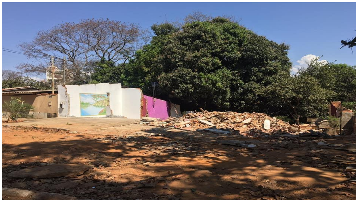
Casas demolidas no Parque Amazônia, em decorrência de processos de reintegração de posse.
