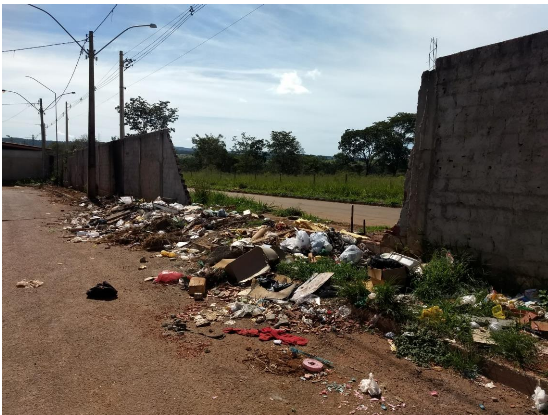
Parte do muro destruída.
